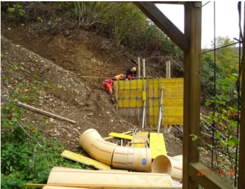
Abb. 31 (1092): 06.10.2017: Einlaufbauwerk 2 (Bauetappe am Anfang des Steilhanges). Im Vordergrund die Rohre und Bögen mit Innen-d 460 mm, für die unterirdische Ableitung.
