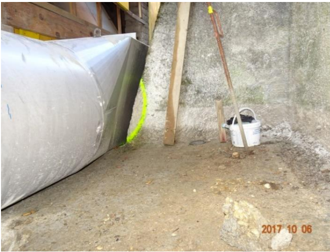
Abb. 34 (1078): 03.10.2017: Stahlkanal beim Konfliktherd Bruchsteinsporn (Ansicht von unten). Der Kanal konnte problemlos eingebaut werden. Markierung am Pfeiler: Nötig gewesene Aussparung für GFK-Normrundrohr D 700 mm, vgl. das 80 mm breite Kantholz, rechts davon. Spornstärke = 1300 mm.
