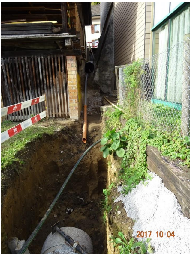
Abb. 38 (1066): Situation am 04.10.2017: Es gibt wieder Probleme: Zu den Rohren fehlen die richtigen Bogen, es ist nur ein 45°-Rohrbogen vorhanden und den kann man hier gar nicht gebrauchen. Gefälle /Gefällewechsel ist seit Ende Planung nicht geändert worden, Rohrbogen waren also seit Monaten bekannt (vgl. aktueller Ingenieurplan Var. 1 - Abb. 4). Ebenso liegen Wellblechschalen bereit, die dann nie eingebaut wurden. Weiter: Es steht der Backsteinpfeiler mit Fundament im gradlinigen Weg, obschon rechts davon genügend Platz vorhanden ist. Bau-stopp (wieder) bis Montag, 16.10.2017
