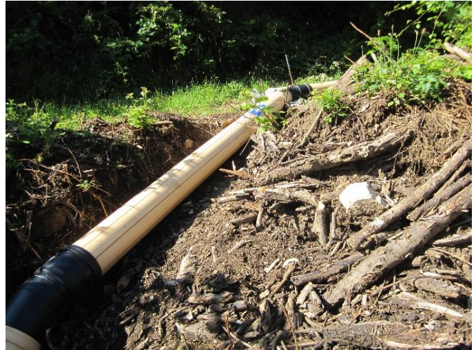
Abb. 53: Zugeschüttete Ablaufrinne auf dem Waldweg Schmälzeried in den Felsbachgraben (natürlicher Wasserlauf). Notdürftig eingelegtes Ableitungsrohr, zweiter Anlauf nach dem Desaster vom 20.06.2016. Und so sah es (wie unter und neben dem Rohr) vor dem Gerölllawinnenniedergang grösstenteils im ganzen Felsbachgraben aus. Das Holz stammt von der Waldrodung her.
