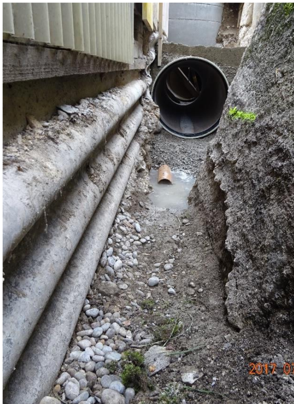
Abb. 25 (389): Konflikt-Situation von unten gesehen. Sehr interessantes Detail: Das Rohr wurde bei dieser «Notverlegung» nicht «in der generellen Gebäudeflucht» verlegt (einbetoniert). Hätte man richtig «gezielt», d. h. das Abflussrohr vorne (im Vordergrund) mehr nach links und hinten mehr nach rechts zur Hänggi-Grenze verlegt, gem. Ingenieurplan 094.03.0994 Schnitte B - B / C - C (Abb. 4), das muss natürlich der Ingenieur der Baufirma vorschreiben, und bei dieser Arbeit muss er unbedingt dabei sein , wäre der Pfeilerkonflikt halbiert worden, also auf 75 mm. Nur, dieses Prozedere wäre aber völlig belanglos gewesen, denn auch die 75-mm-Kleinigkeit konnte (durfte) man (für die Verlegung eines Normrohres) vom 1.23-m-Bruchstein-Pfeiler (d. h. der heiligen K., rechts im Bild) nicht abfräsen!!! Beachte auch die Bergdruck-/Grundwasseransammlung.
