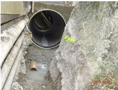
Abb. 103: Eilends einbetoniertes Rohr, auf Intervention des Geologen/Baustatikers und meinen Vorbereitungen zum Zube-tonieren des Grabens hin (wegen offenen, ungesicherten Bau-gruben und entstandenen Rissen am Schopf 24a). Das Rohr liegt nicht ganz in der Haupt-Flucht, vgl. auch Detailbescrieb in Abb. 25. Rechts im Bild: Konfliktpfeiler.
