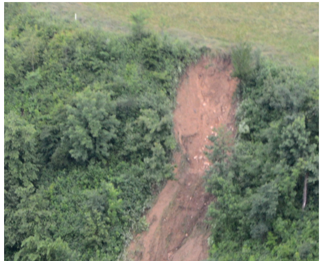
Gut zu erkennen die Abrisskante oben an der Wiese, weiter unten sind nur noch Rutschspuren zu sehen.
